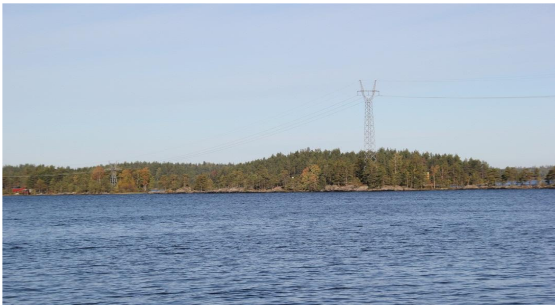
Kuva 4. Kuvassa on Iso - Matarilta kuvattu 110 kV voimajohdon Huutokoski - Savonlinna pylväs 280.
